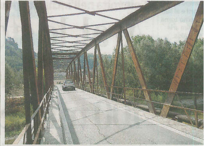
Il ponte di Melazzo ha necessità di interventi urgenti
